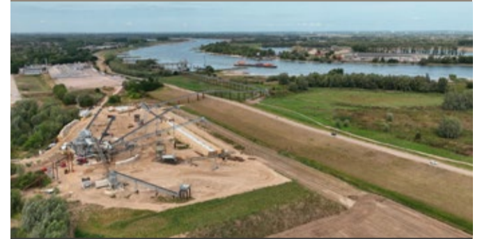
De zandklasseerinstallatie met transportband tot aan de Waal
